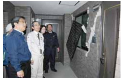
24日ドアが曲がり壁に亀裂、中央区のマンション
